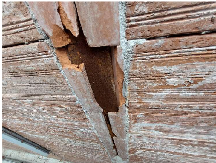
Obrázek č. 6 – Detail odpadlé části stropu
