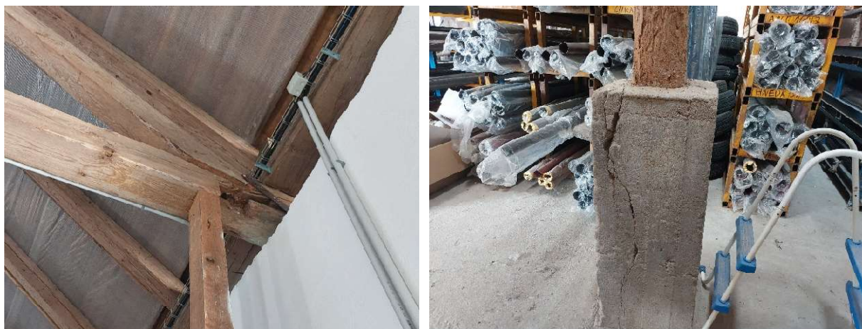
Obrázek č. 3 - Uhnilé (biologicky zdegradované) ev. přeříznuté/nespojené zhlaví vazných trámů/sloupků/pozednic
