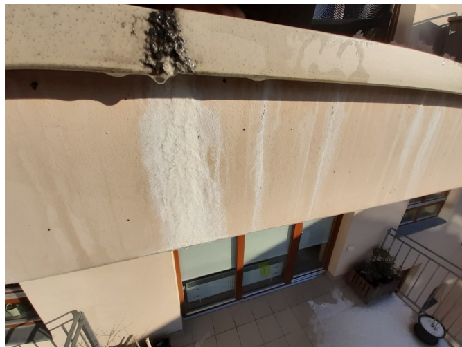
foto /3/ Výluhy na nosné konstrukci balkonů
