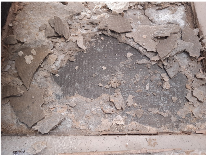
foto /6/ Místo demontáže nášlapné vrstvy – degradace lepicího tmelu a nesoudržnost s hydroizolační stěrku
