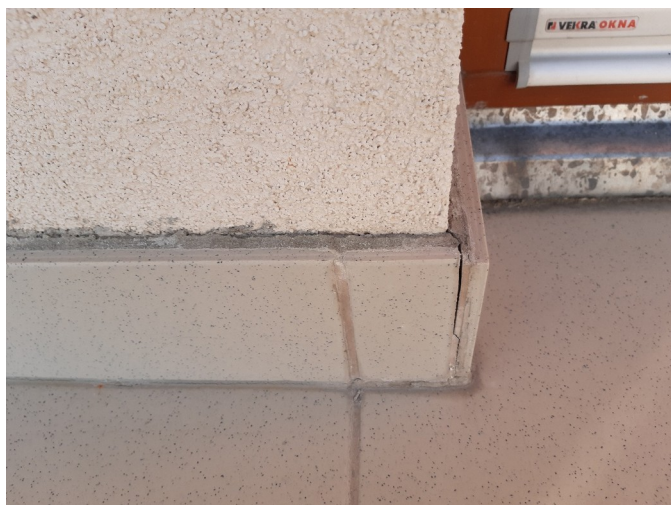
foto /8/ Odtržení soklových dlaždic od podkladu
