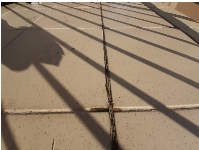
foto /2/ Zdegradovaná spárovací malta
