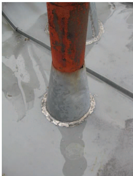
Obr. 31: Nedostatečné vodotěsné opracování prostupu
