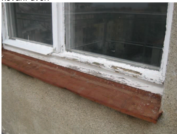
Obr. 107: Oprýskané výplně otvorů
