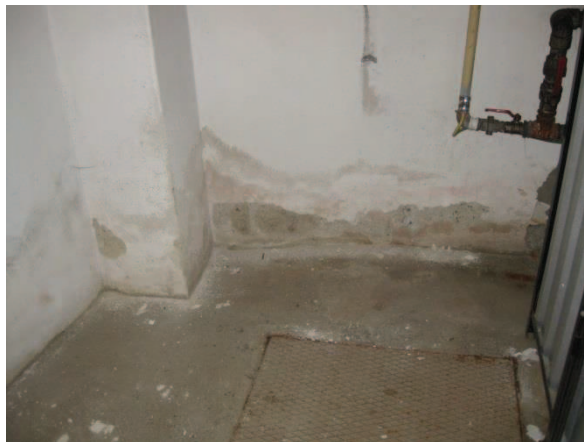
Obr. 124: Lokální vlhkostní poruchy v suterénu
