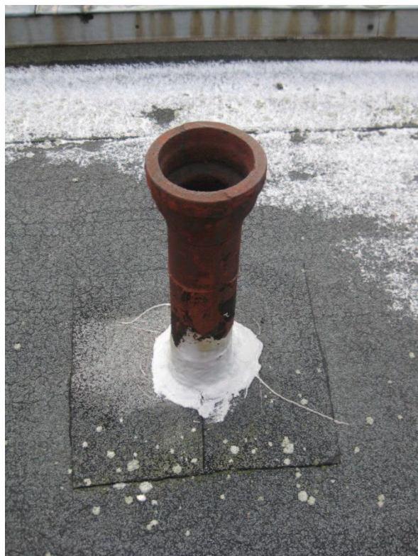
Obr. 57: Nevhodně opracovaný prostup pomocí pojistné zálivky
