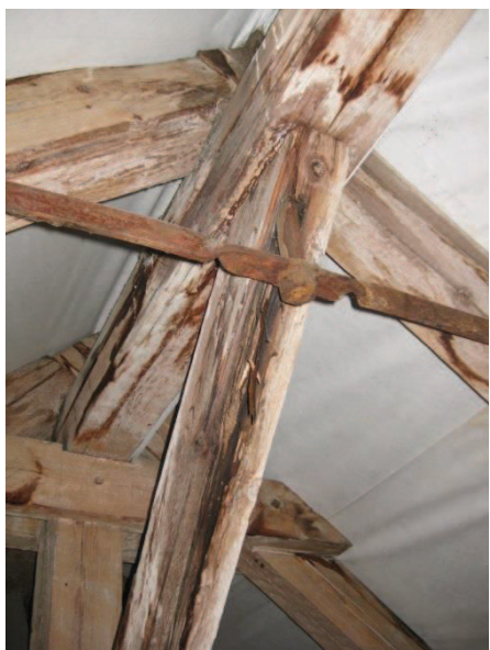
Obr. 45: Sonda S27 – poškození vrcholové vaznice a pásku
