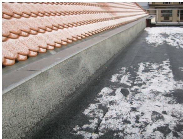
Obr. 66: Degradace asfaltového pásu na atice
