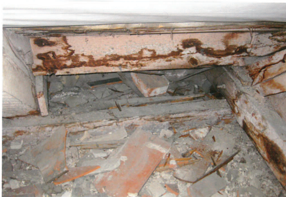
foto č. 6- poškození části pozednice hnědou hnilobou, sonda č. 19
