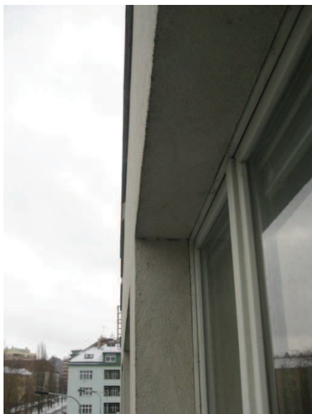
Obr. 95: Absence okapničky v nadpraží okna
