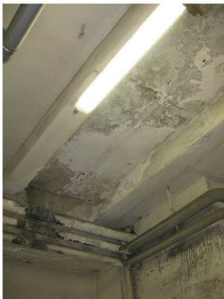
Obr. 121: Stav železobetonové stropní konstrukce pod průjezdem (degradace zatékáním)
