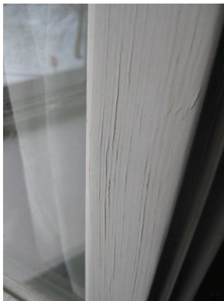
Obr. 96: Dožívající nátěr dřevěných okenních výplní
