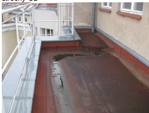
Obr. 74: Odvodnění střechy C1, tvorba kaluží v důsledku nedostatečného spádu
