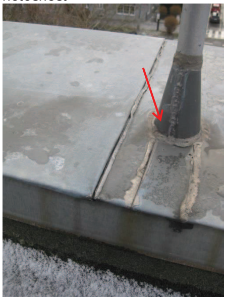
Obr. 61: Nevhodný způsob spojování atikových plechů, dožilý tmel
