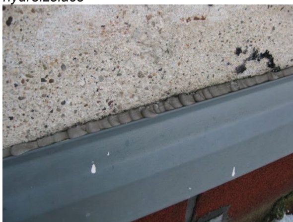
Obr. 79: Netěsné provedení tmelů, které jsou již dožilé
