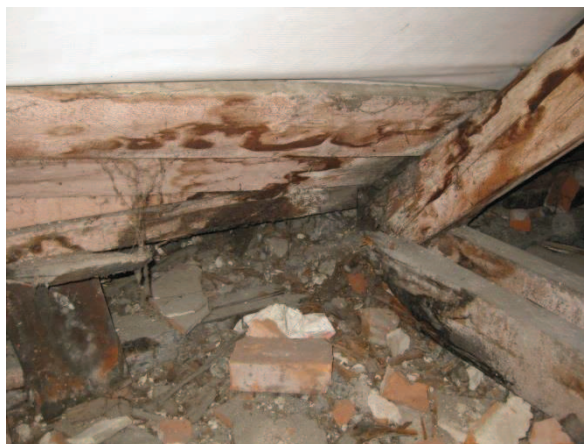
Obr. 40: Místo provedené sondy S18 v rámci mykologického průzkumu, poškozené zhlaví krokví a kleštin, lokální absence pozednice
