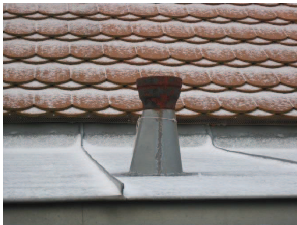
Obr. 32: Nedostatečné vodotěsné opracování prostupu
