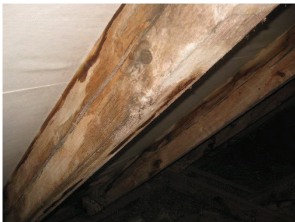
Obr. 43: Detail zvlhlých horních líců krokví
