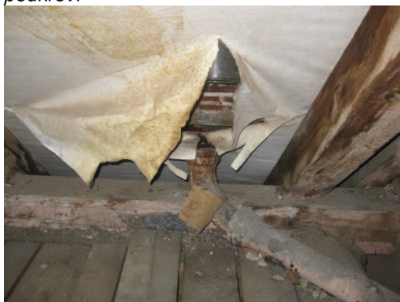
Obr. 48: Poškozená pojistná hydroizolace, ukončení splaškové kanalizace do podkroví, kondenzace vodní páry na přilehlých konstrukcích
