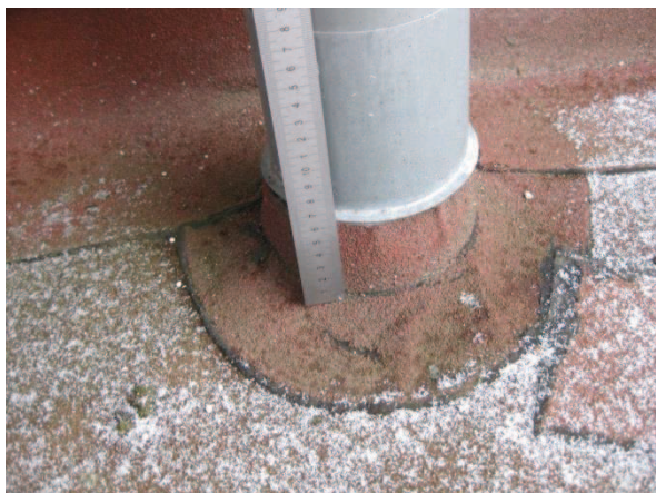
Obr. 77: Detail prostupu dešťového svodu na střeše C, nedostatečné vytažení hydroizolace
