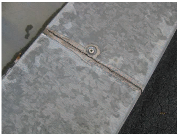
Obr. 65: Absence puklíku na kotvicím prvku, netěsnost ve spoji plechů
