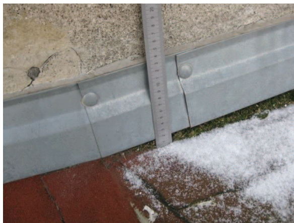
Obr. 78: Lokálně nedostatečné vytažení hydroizolace na svislou obvodovou konstrukci
