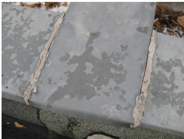
Obr. 63: Oplechování atiky u žlabu, dožilý tmel, nevhodný spoj plechů
