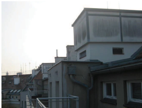
Obr. 26: Strojovna výtahu se znečištěnou obvodovou konstrukcí
