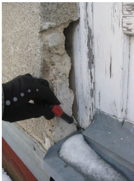
Obr. 102: Netěsnost u dveřního prahu v důsledku dožilé omítky
