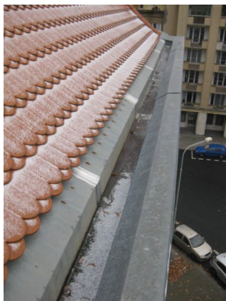
Obr. 13: Plechový žlab odvodňující sedlovou střechu v uliční části a jeho spoje přelepené samolepící páskou
