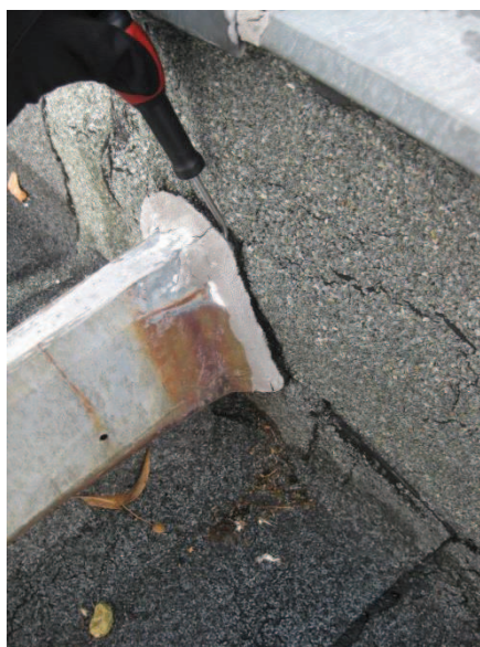
Obr. 56: Dělicí „atika“ uprostřed střechy B, možné netěsnosti
