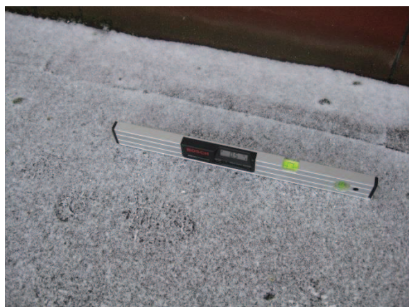
Obr. 73: Nedostatečný spád střech C
