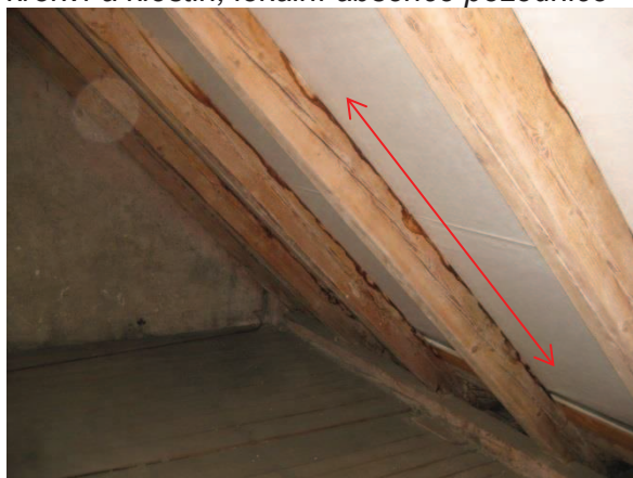
Obr. 42: Zvlhlé horní líce krokví v celé jejich délce
