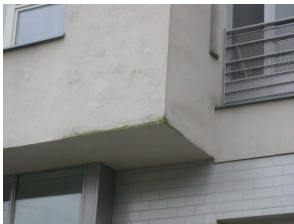
Obr. 92: Lokální výskyt řas a plísni na části fasády
