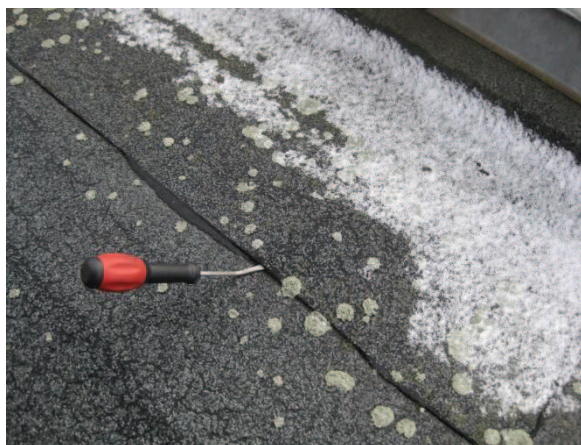
Obr. 58: Netěsnost ve spoji asfaltových pásů
