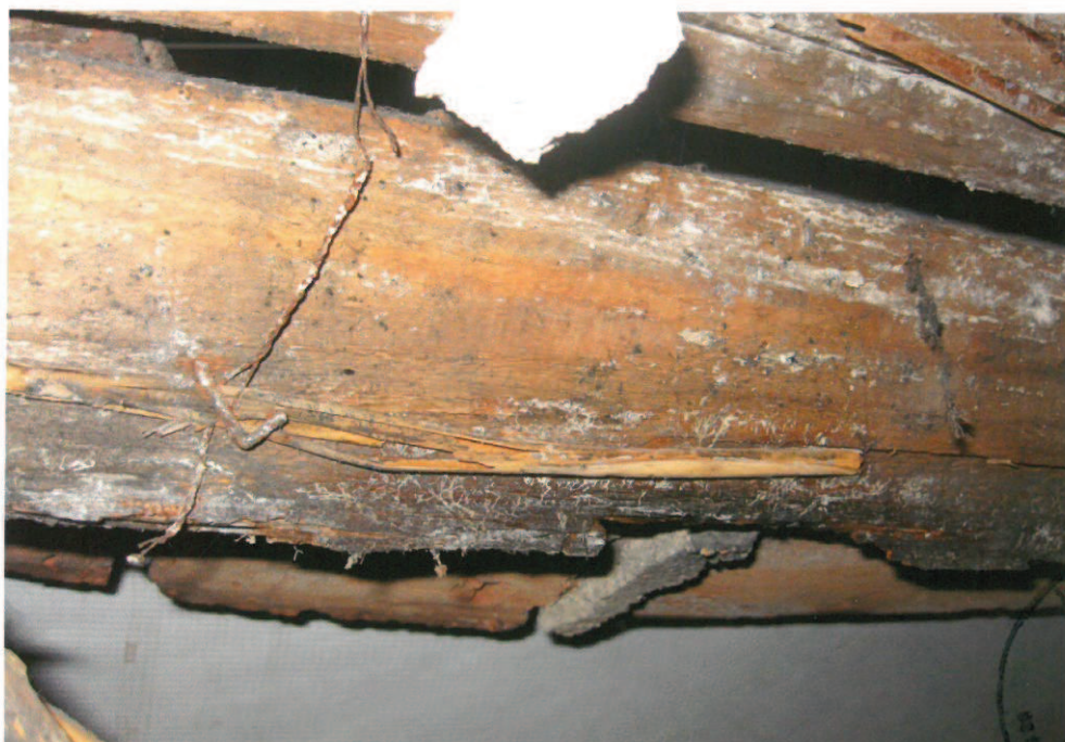
foto č. 1- podbití pod oknem poškozené hnědou hnilobou, sonda č.12
