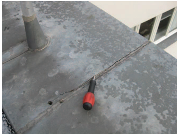
Obr. 60: Trhlina v oplechování atiky tvořící netěsnost
