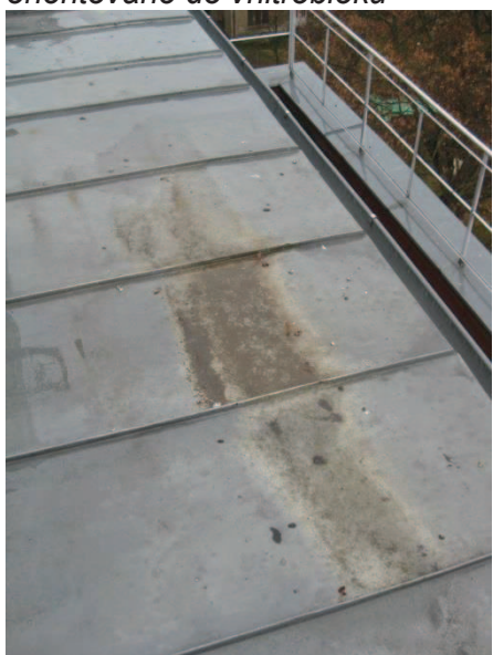
Obr. 21: Lokálně nedostatečný spád v plechové krytině a tvorba kaluží
