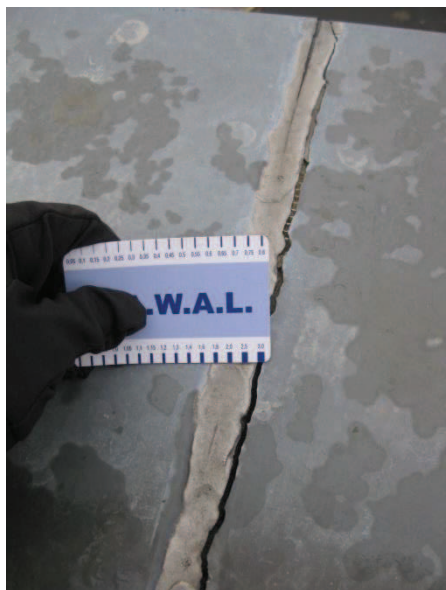
Obr. 59: Trhlina v oplechování atiky tvořící netěsnost
