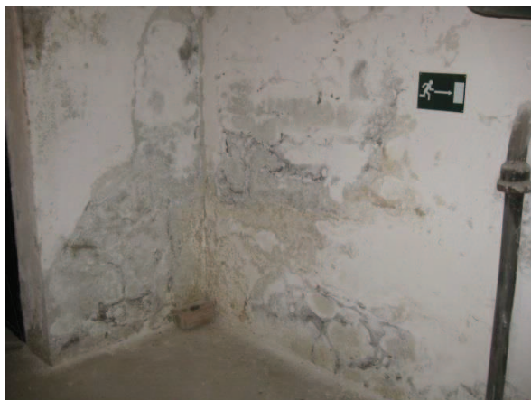
Obr. 117: Suterénní prostory objektu a lokální vlhkostní poruchy
