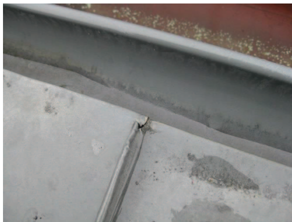
Obr. 22: Netěsnost ve spoji plechové krytiny při okapní hraně
