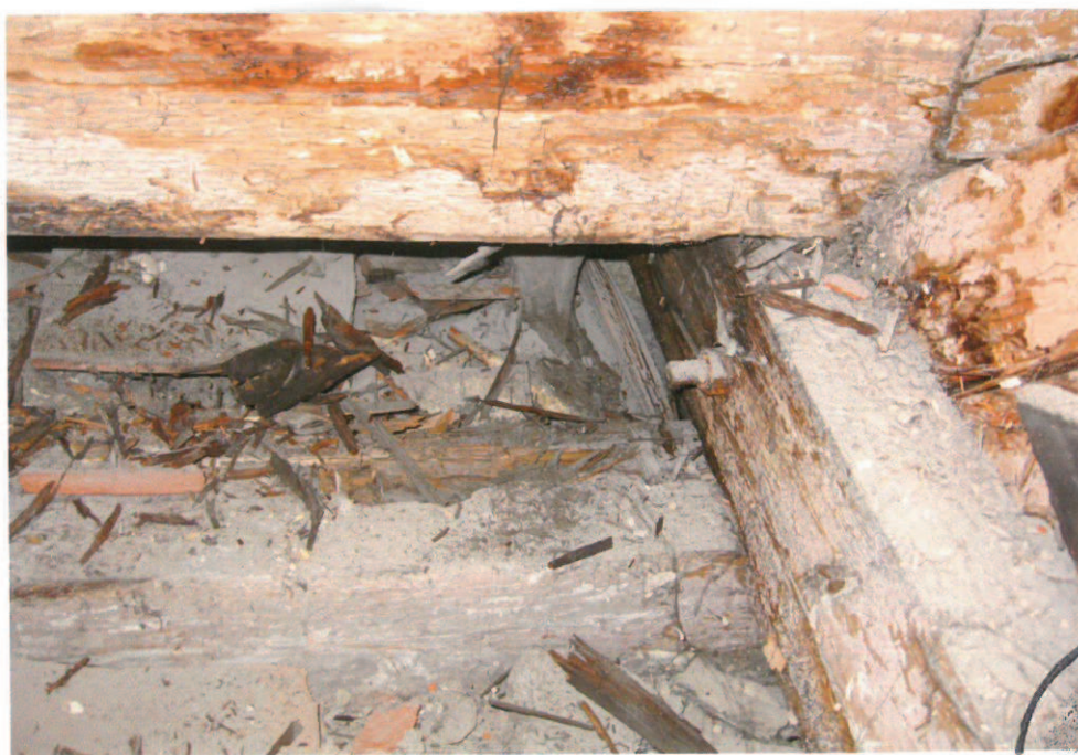
fotoč.2 - část pozednice poškozena hnědou hnilobou, sonda č. 16
