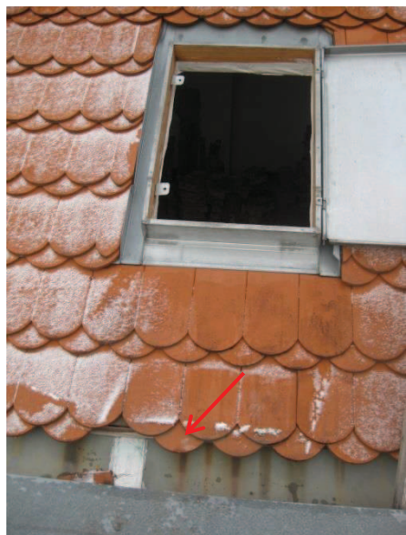
Obr. 7: Střešní výlez na střeche B, absence střešní tašky
