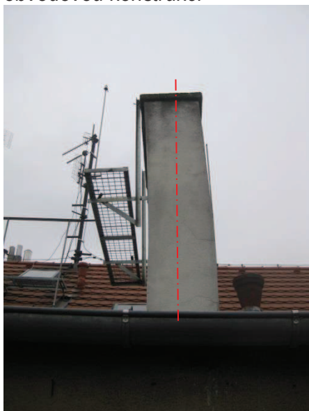
Obr. 27: Komínové těleso a jeho deformace
