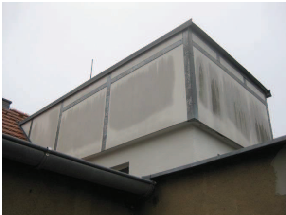
Obr. 25: Strojovna výtahu se znečištěnou obvodovou konstrukcí
