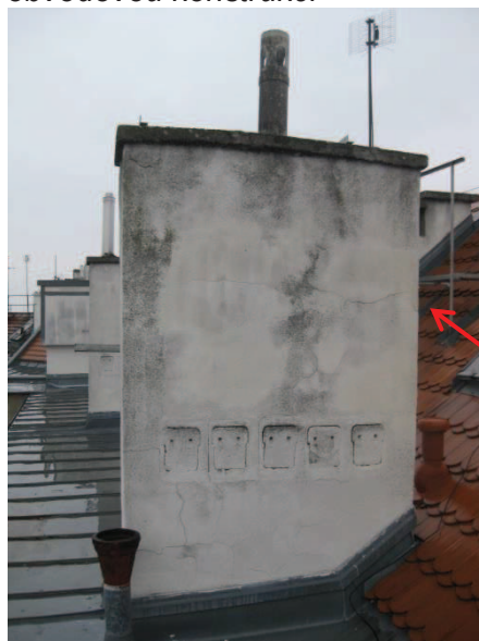
Obr. 28: Komínové těleso a vzniklá tahová trhлина
