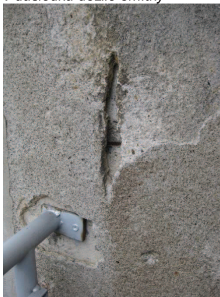
Obr. 104: Degradovaná původní omítka v 5.NP
