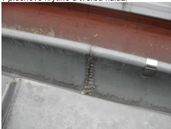
Obr. 23: Trhlina v letovaném spoji podokapního žlabu
