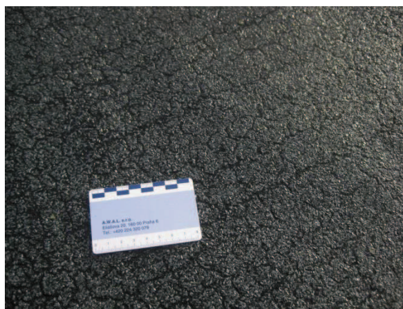
Obr. 54: Stav hydroizolačního povlaku střechyn B – tzv. krokodýling
