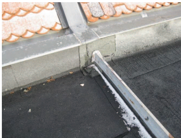
Obr. 62: Dělicí „atika“ střechy B pravděpodobně přemostující dilatační spáru, rizikové místo s netěsnostmi
