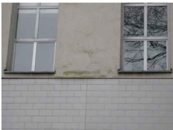
Obr. 93: Lokální výskyt řas a plísni na části fasády
