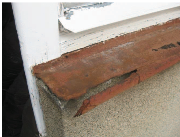
Obr. 108: Dožilé oplechování parapetů
