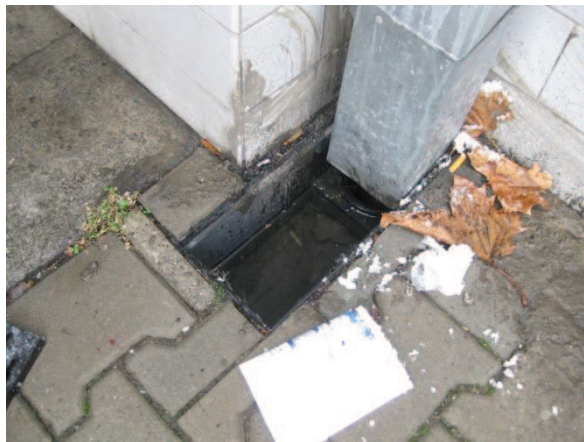
Obr. 128: Chybně (obráceně) osazený lapač střešních splavenin v uliční části
