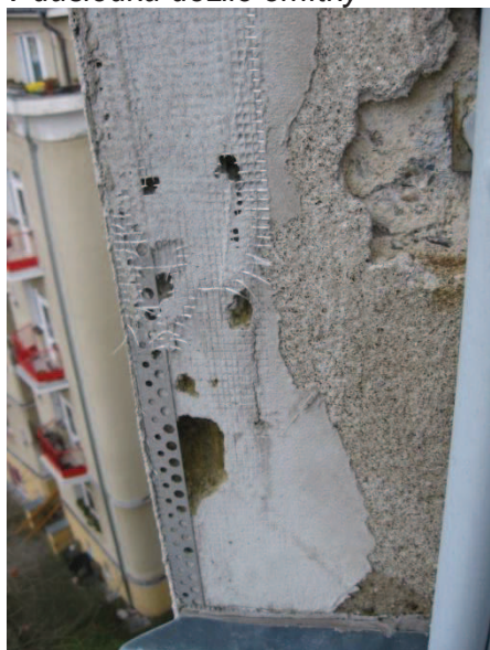
Obr. 103: Lokálně nezačištěný detail - absence finální povrchové úpravy, poškození zateplovacího systému
