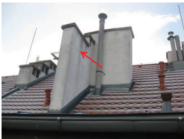
Obr. 29: Komínové těleso a vzniklá tahová trhлина
