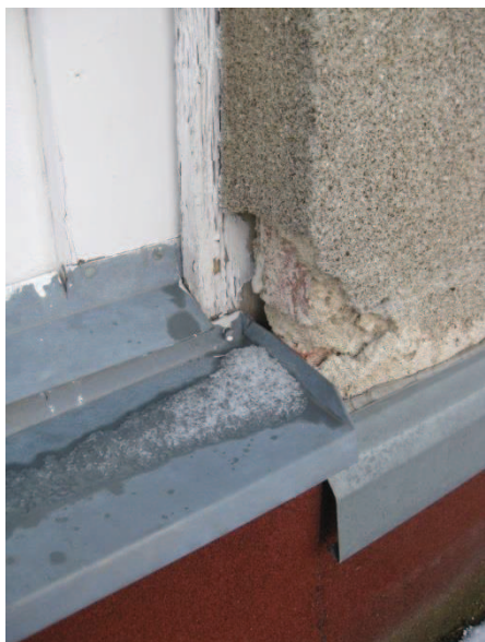
Obr. 101: Netěsnost u dveřního prahu v důsledku dožilé omítky
