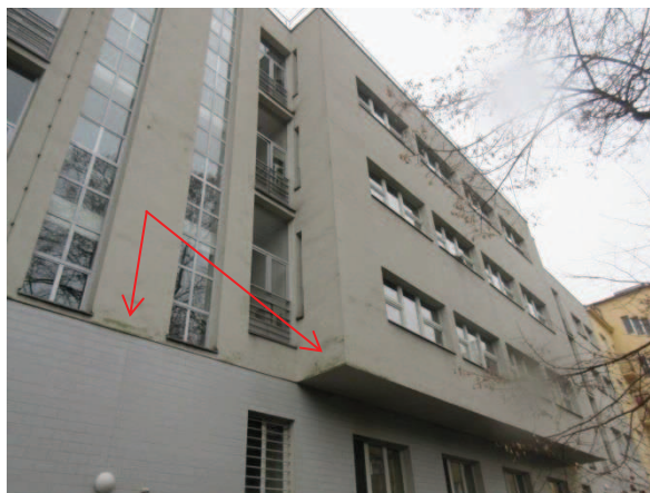
Obr. 90: Fasáda orientovaná do vnitrobloku, lokální výskyt zelených řas
