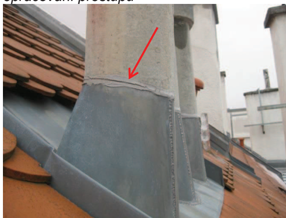
Obr. 34: Dožilé tmely na prostupech střechy
