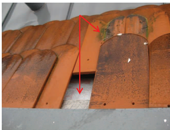
Obr. 12: Uvolněné střešní tašky a jejich absence
