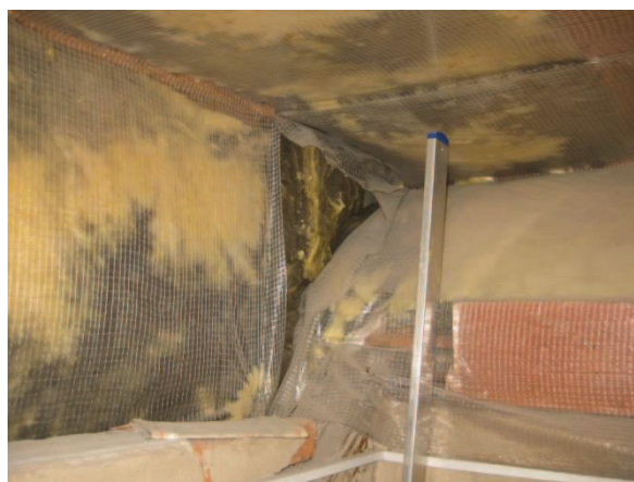
Obr. 50: Neodborné provedení parozábrany ve strojovně výtahu, tvorba plísní
