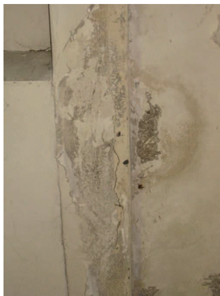
Obr. 122: Stav železobetonové stropní konstrukce pod průjezdem (degradace zatékáním)
