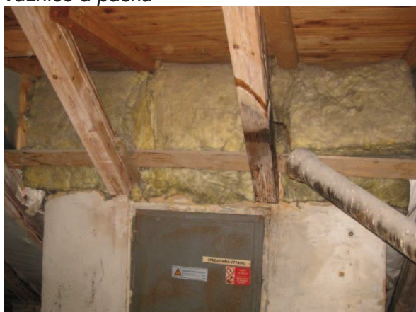
Obr. 47: Absence parotěsného uzavření tepelné izolace strojovny výtahu, vyústění splaškové kanalizace a dotace okolního prostoru vlhkostí
