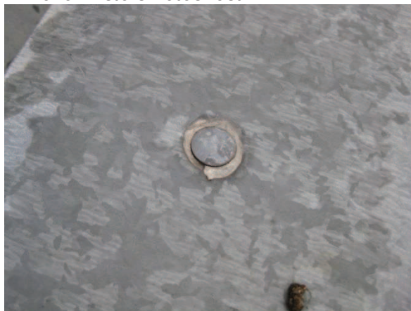
Obr. 64: Dožilý tmel v místě puklíku na kotvicím prvku plechu
