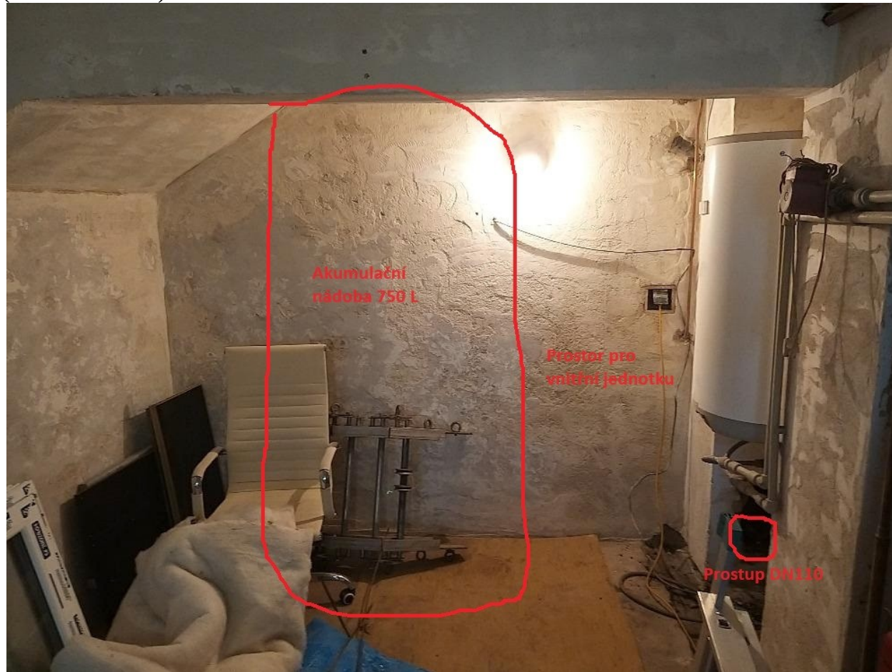
Foto technické místnosti (bude uklizeno :-)
