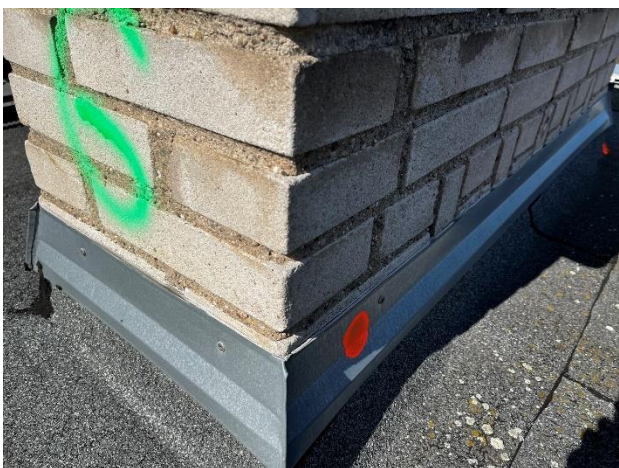
Obr. /34/ Degradace pojistného tmelu
