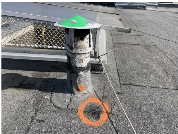
Obr. /19/ Kapilární poruchy a perforace
