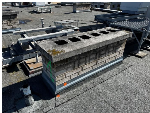
Obr. /31/ Chybějící stříška komínů
