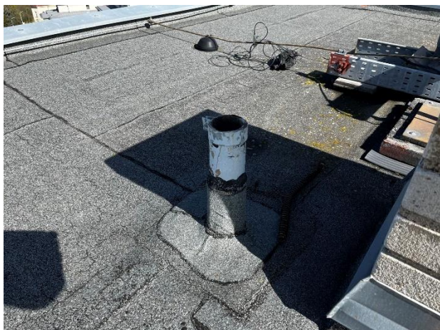
Obr. /30/ Chybějící stříška prostupu
