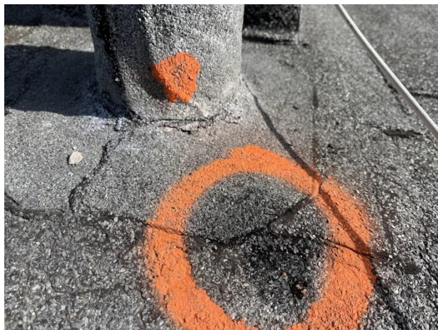
Obr. /18/ Kapilární poruchy a perforace
