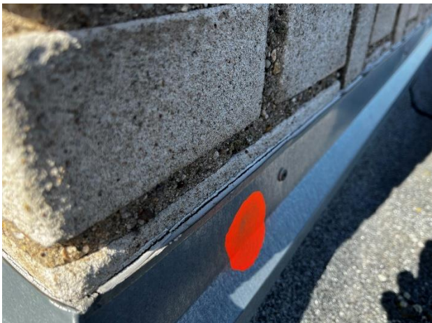
Obr. /32/ Degradace pojistného tmelu
