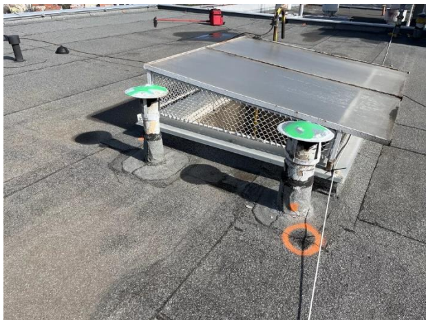
Obr. /17/ Kapilární poruchy a perforace
