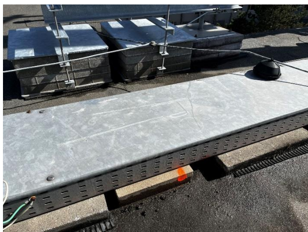
Obr. /37/ Chybějící podložky
