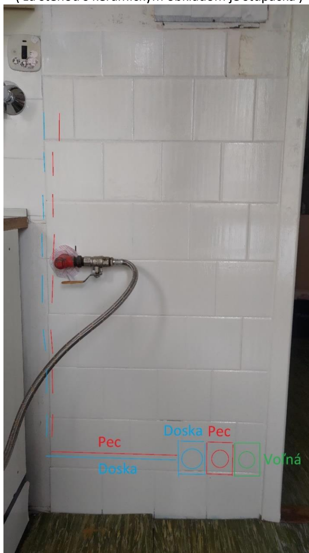
Ukončenie napájacích obvodov pre varnú dosku a pec zásuvkami v kuchyni ( za stenou s keramickým obkladom je stupačka )
