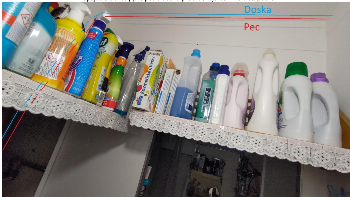
Napájacie obvody pre pec a dosku prechádzajú cez WC a stupačku
