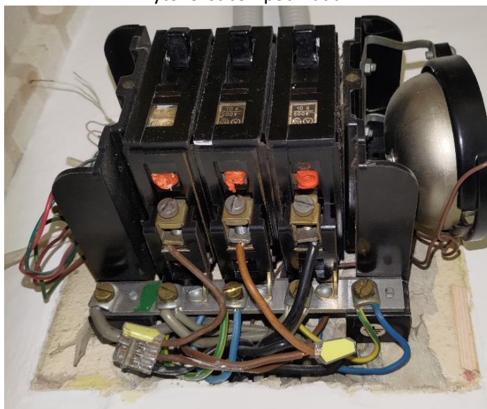
Bytové ističe z podhľadu
