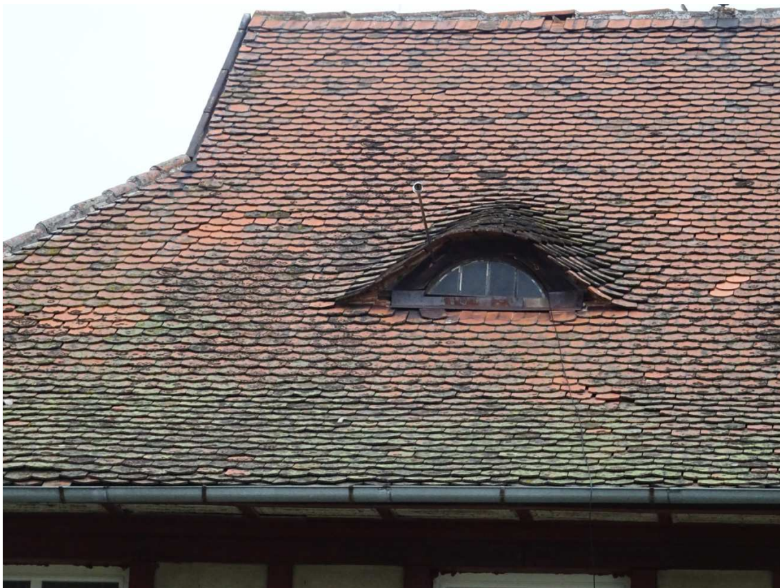
Volské oko s kamerovým systémem na jižní straně objektu
