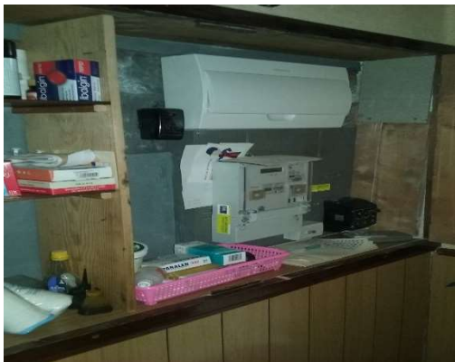
2NP elektroměr uvnitř bytu – vedle dveří
