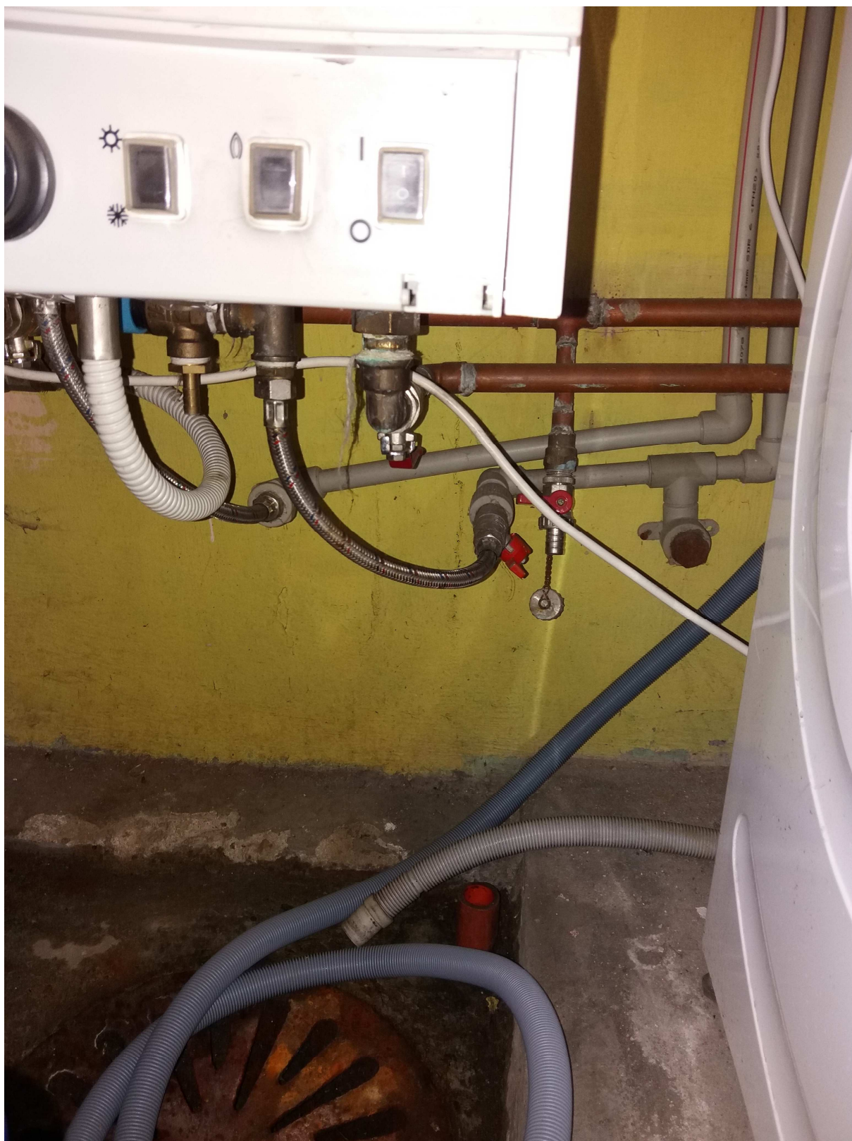
Kotelna – rozvody vody
