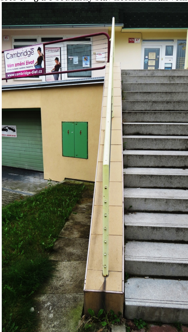
foto č. - 5 a 6 současný stav horních hran venkovního schodiště
