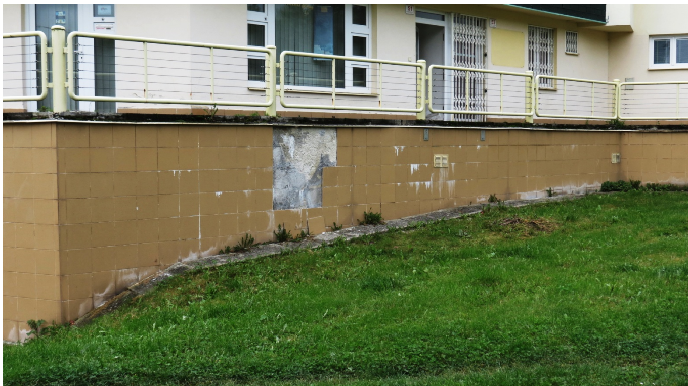
foto č. 3 – současný stav obkladu fasády I. PP
