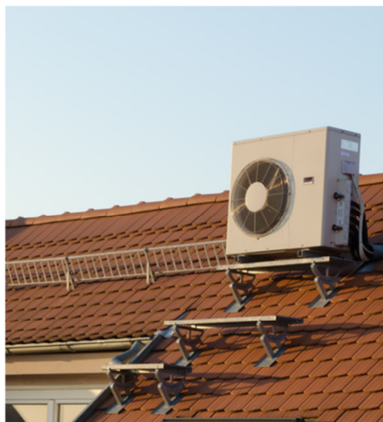
provedení obdobné instalace
