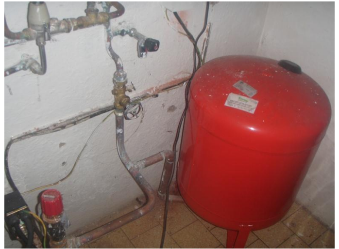
Obr 8. Vodárna II – tlaková nádoba
