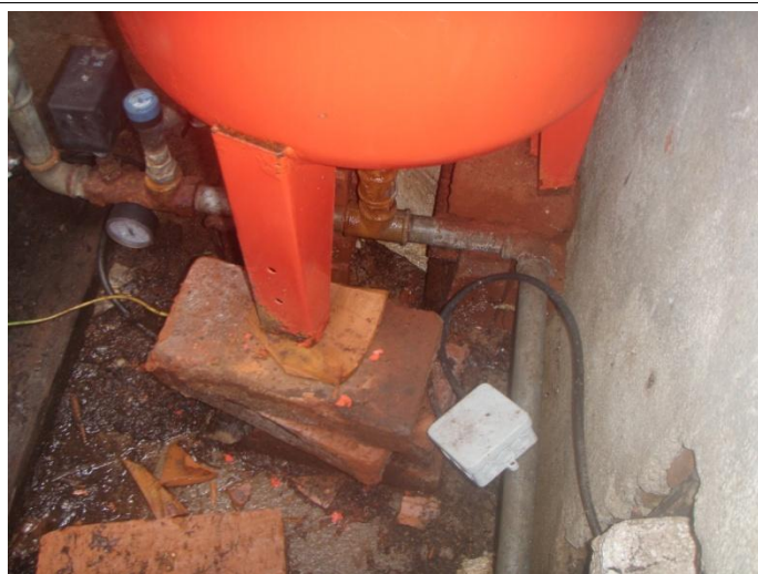
Obr 3. Vodárna I – střední část potrubí
