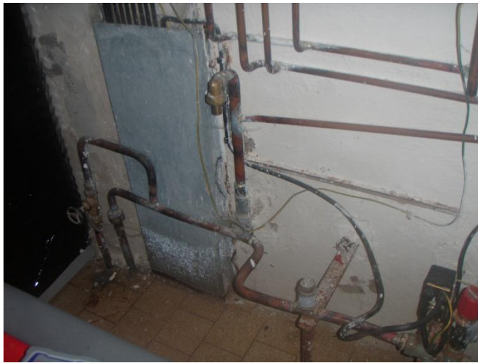
Obr 7. Vodárna II – potrubní rozvody
