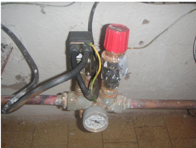
Obr 9. Vodárna II – regulátor a pojišťovací ventil
